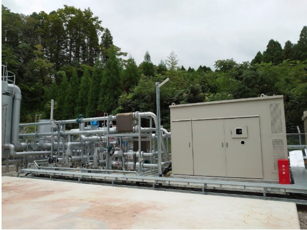
写真2. バイナリータービン発電装置
