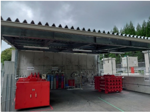
写真6. 水素充填・出荷場
